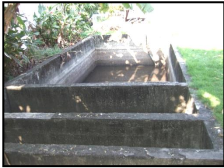
บ่อดักไขมันและขยะ ของน้ำทิ้ง ก่อนเข้าสู่บ่อคลองวนเวียน
